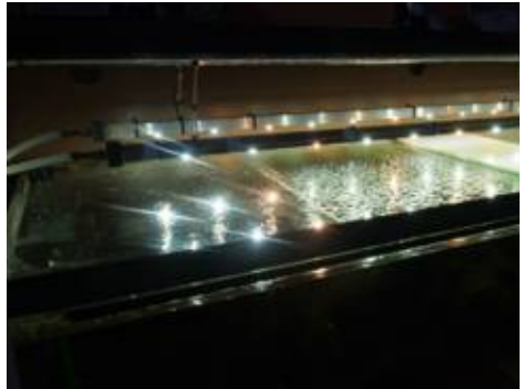
Abbildung 3: Hier die fertig montierte LED-Beleuchtung.
