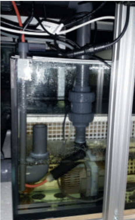
Rückführung des Wassers ins Aquarium
