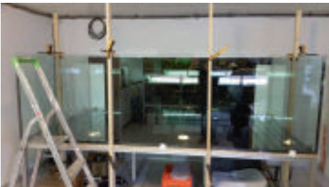
Alle Scheiben stehen und sind gesichert
