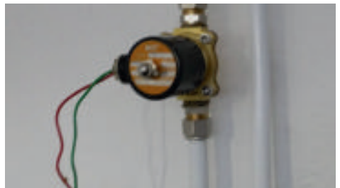
Das Magnetventil zur Regelung der Heizung
