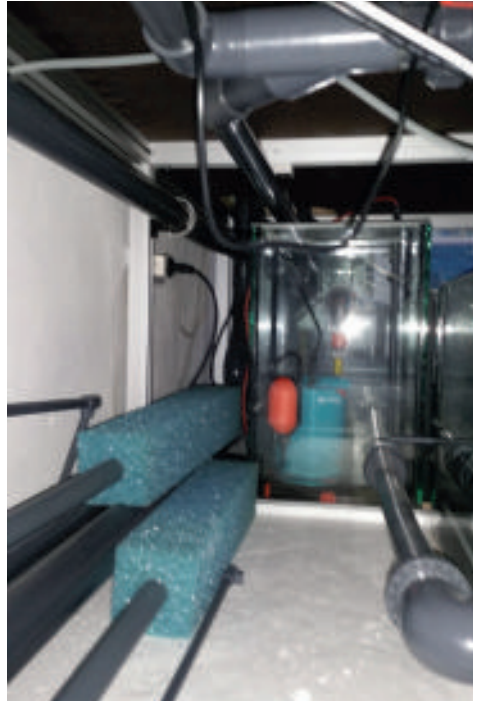
Blick hinter die Filterbecken
