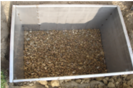
Bild 2: Drainagemulde mit Kies aufgefüllt, auf den Kies feinmaschigen Draht gelegt (Mäuseschutz), dann noch den Draht mit Filtervlies abgedeckt.
